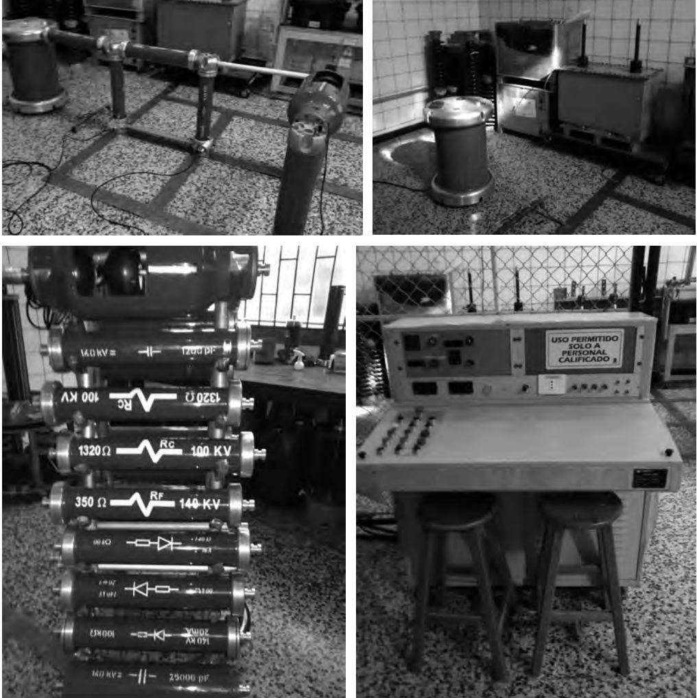
Figura 6. Laboratorio de alta tensión, iluminación y máquinas eléctricas
